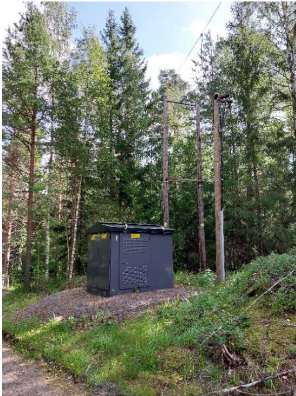
Kuva 10-1. Puistomuuntamo Santakosken pohjavesialueella.
